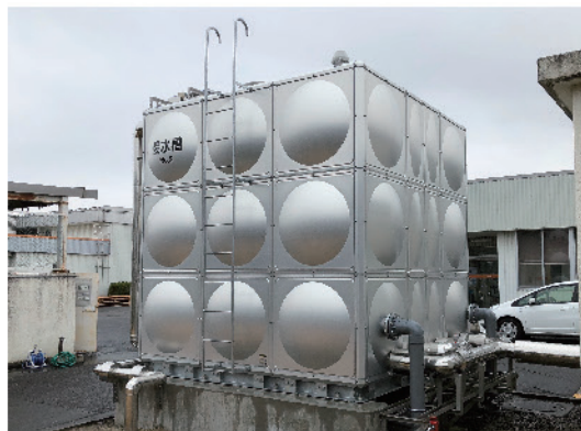
貯水槽タンク
